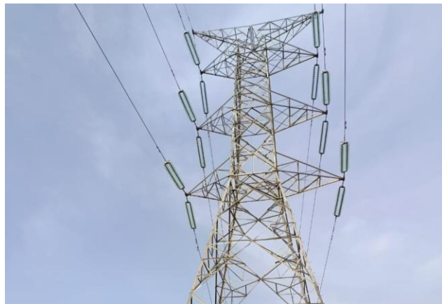
Ligne de transport 225 kV CC Garoua-Maroua (Cameroun)
