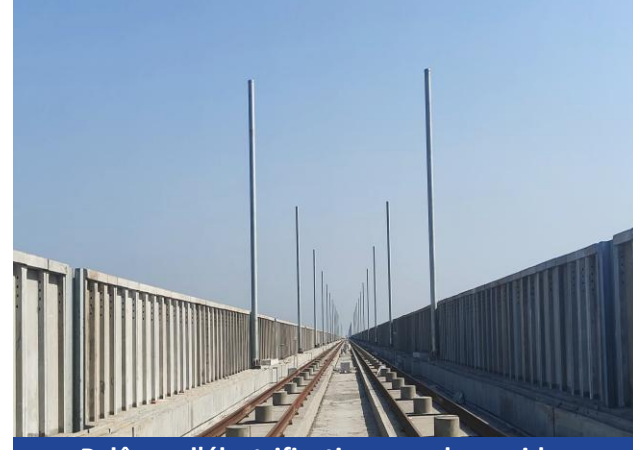
Pylônes d'électrification pour le corridor ferroviaire à grande vitesse Mumbai- Ahmedabad
