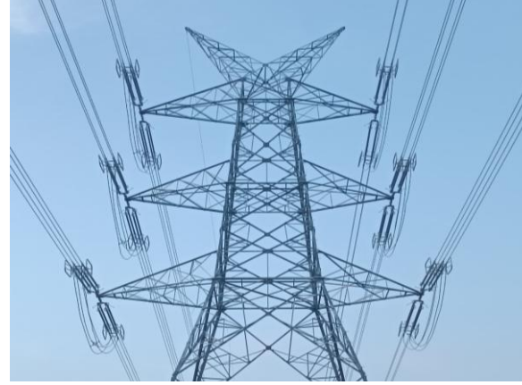
Ligne de transmission 400 kV CC, Neemuch - Mandsaur
