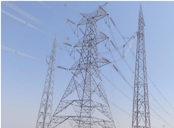
Lignes de transport CC de 765 kV à Khavda
